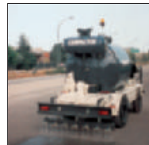
Riego rampa fija 1,25 m.
